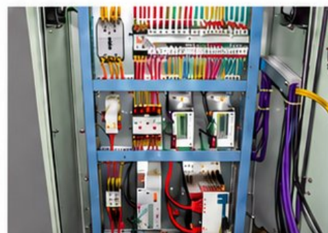
Sistema de controle computadorizado
